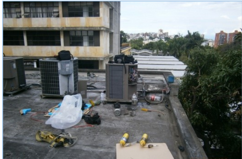
Nueva unidad de aire acondicionado para el Laboratorio de Habilidades
