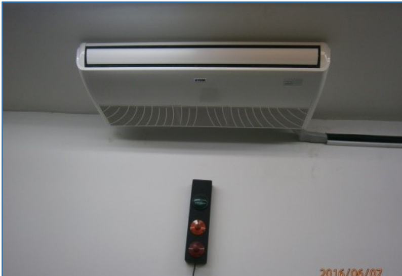
Nueva unidad de aire acondicionado, salón 201 del Edificio 116
